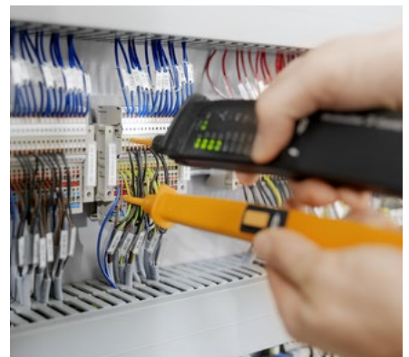
Fehlersuche mit zweipoligem Spannungsprüfer inkl. Prüfspitze nach IEC 61243-3
